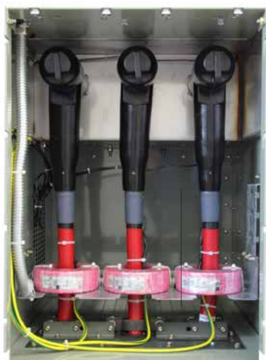
Conexión 630 A (compartimento de cables en el módulo L)
